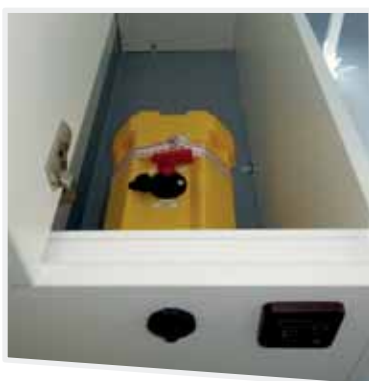
Batterie dans banc coffre
